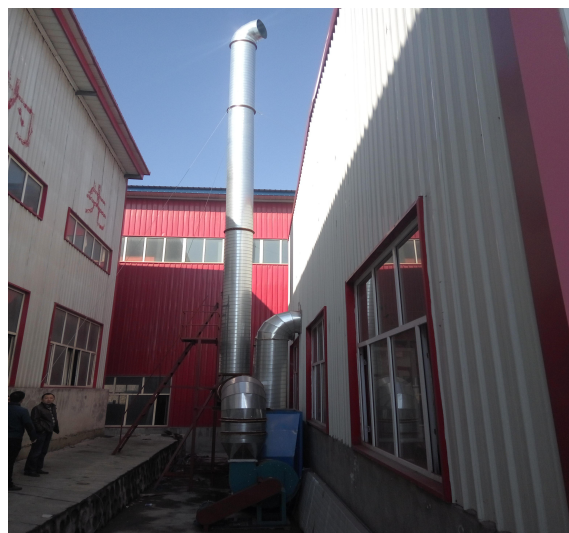
喷漆车间废气处理设备
