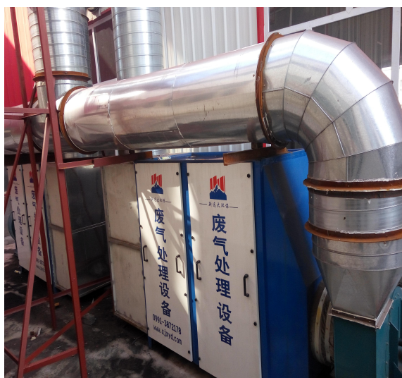
喷漆车间废气处理设备
